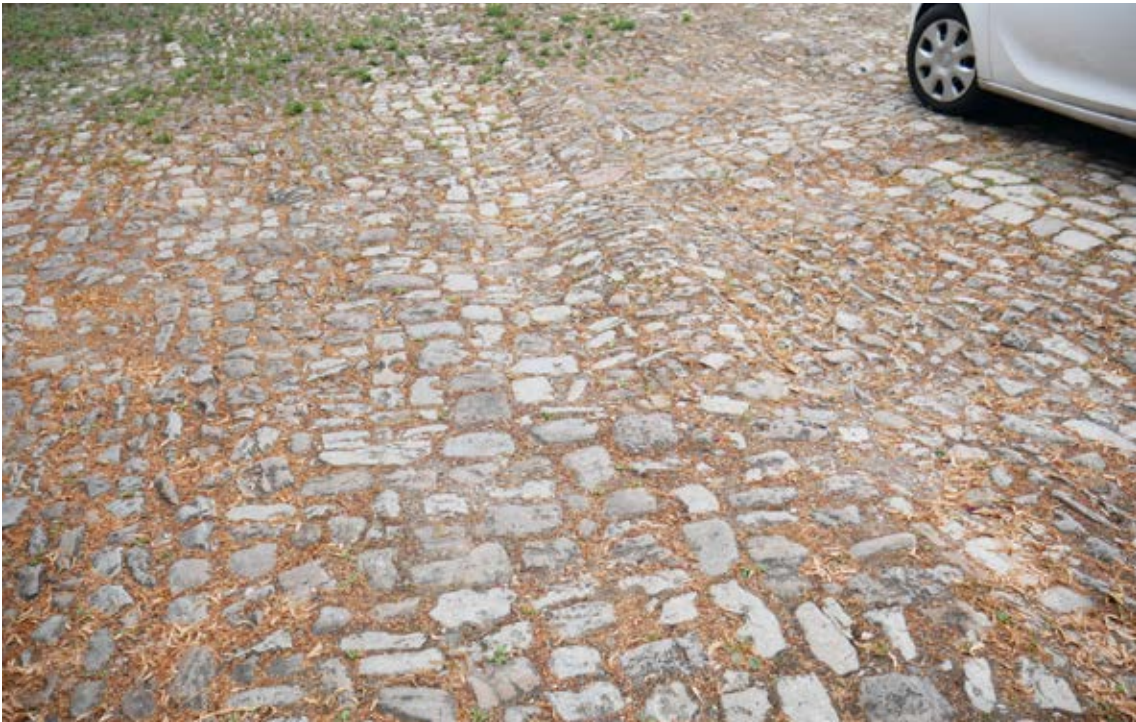
Schäden in der Pflasterfläche am Salzmarkt, p&w 2022
