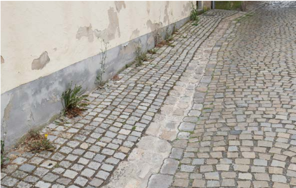
Gliederung und Ausführung der Seitenbereiche sind gestalterisch ungenügend, p&w 2022
